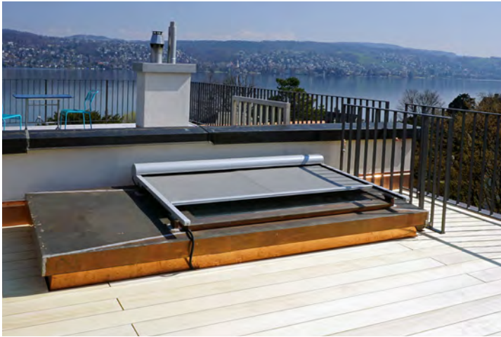
Stores extérieurs électriques
